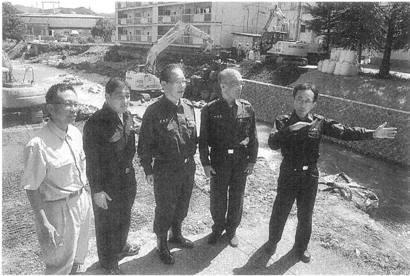
護岸の崩落現場を視察する魚住(中央)、荒木(同右)、伊藤(左端)の各氏ら=18日 岐阜・高山市
